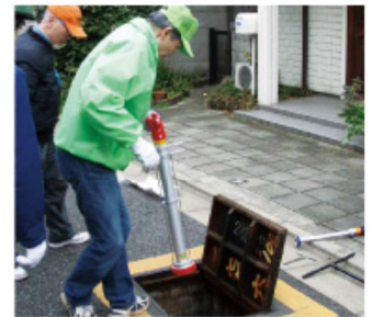
消火栓に差し込む
