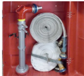
スタンドパイプとホース
